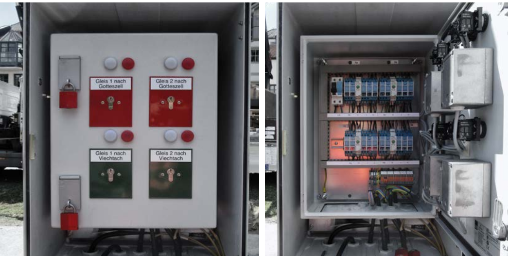
Schlüsselsicherung an der Strecke Gotteszell - Viechtach" © FES Bahntechnik
